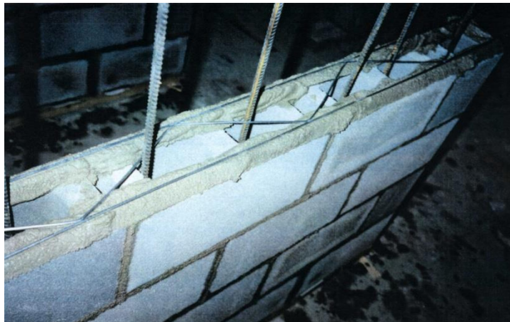
Figura 9 - Vista de un murete con sus armaduras vertical y horizontal en las juntas, antes de que se rellenen los huecos con un hormigón de consistencia líquida.
